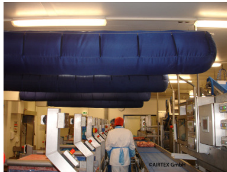
Textile ventilation ductwork Airtex Bioactive in production unit of fresh meat manufacturing Industry. Photo: Airtex GmbH Textile Luftkanäle Airtex Bioactive für Produktionsbereich in Frischfleisch verarbeitender Industrie. Photo: Airtex GmbH
